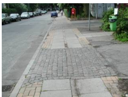
Gangbane afbrudt af brosten
