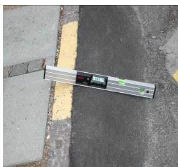
Rampe, som er for stejl
